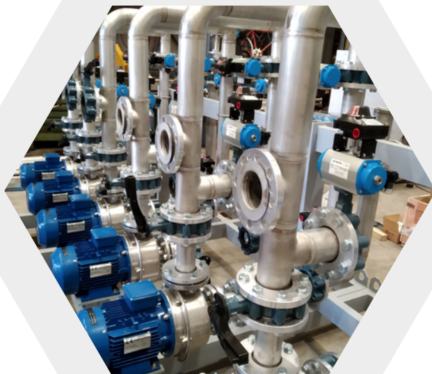
2. Skid per miscelazione detersivi per impianto di dosaggio
